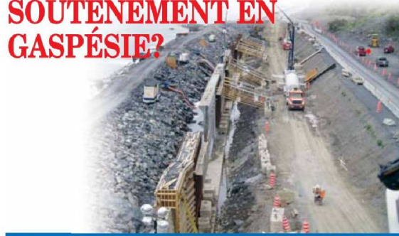
La seconde phase d'un mur de soutènement a été complétée à Saint-Maxime-du-Mont-Louis en novembre dernier.
