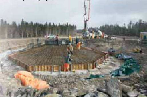
Ce projet de 700 millions de dollars prévoit 150 éoliennes produisant chacune 2 MV pour un total de 300 MW.
