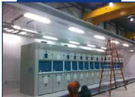
A. Lecompte travaille activement pour décrocher des contrats dans le cadre du Plan Nord. Voici un abri électrique expédié dans le Grand Nord.
