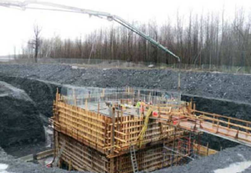
Mise en place des formes pour la construction de la dalle du pont d'étagement de l'autoroute 30 en direction est, qui passe au-dessus de la route 930.
